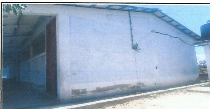
Foto 4: mejoramiento de pintura general, el color de las paredes del establecimiento ya no es de ambiente agradable para los niños ya que está muy descolorida porque no se ha pintado durante varios años.
