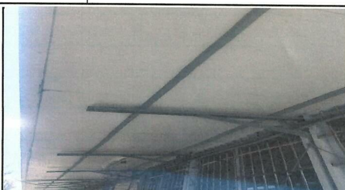
Foto 2: se instalará canales y bajadas de agua pluvial, actualmente no tiene y el agua de la lluvia esta dañando la estructura del techo.
