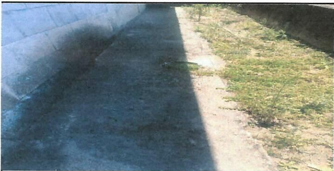
Foto 3: se instalará losa de patio ya que actualmente solo cuenta con una pequeña banqueta hecha con fondos de padres de familia y lo demás es de pura tierra que se vuelve lodoso en época de invierno.
