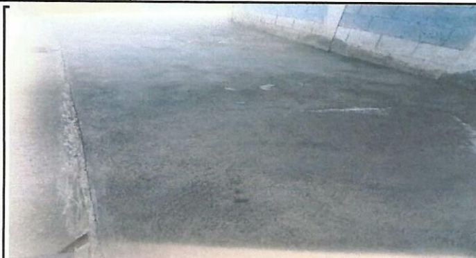
Foto 1: se instalará piso formal en todo el corredor ya que actualmente solo existe torta de cemento ya porosa debido al paso de los años
